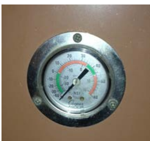
✕ Jauge de température défectueuse (salle d'entreposage des déchets biomédicaux)
